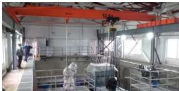
На фото: ручная кран-балка опорная грузоподъемностью 12,5 тонн, установленная в производственном помещении. Рабочим органом крана является таль ручная передвижная ТРШСМ г/п 12,5 тонн.
